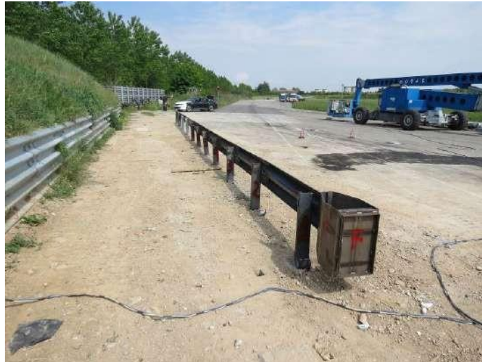
Figura 3 - Vista geral do dispositivo / General view of the device
